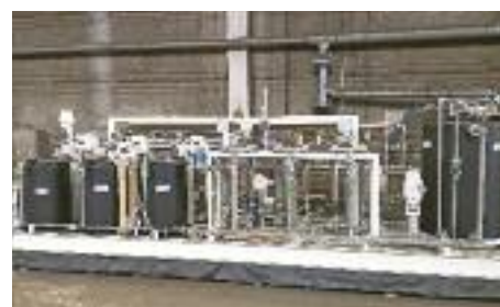
SKID E IMPIANTI DI OSMOSI INVERSA TRATTAMENTO A MEMBRANA
