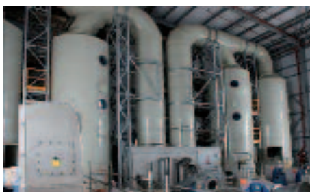
TRATTAMENTO DI EFFLUENTI GASSOSI CON ABBATTITORI AD UMIDO
