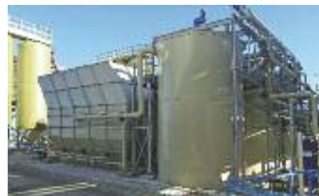
RIMOZIONE SELENIO E MICROINQUINANTI
